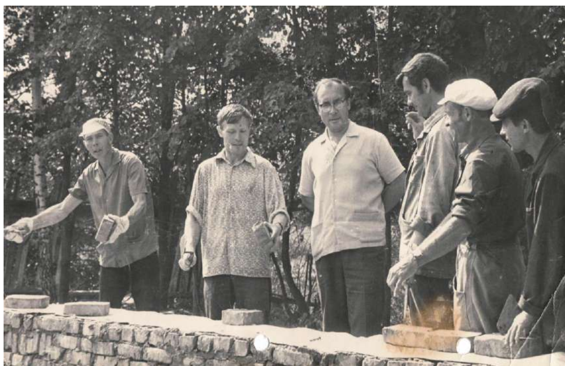
Строительства Тохмеевского сельского клуба. Третий слева – председатель колхоза «Звезда» - Зинон Аркадьевич Абдулкин
